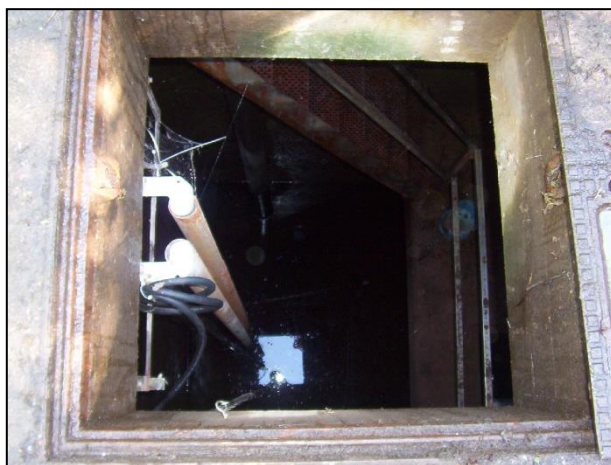
Abbildung 5: Mess- und Pumpenschacht PM
